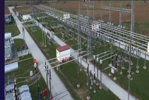
Trạm biến áp
